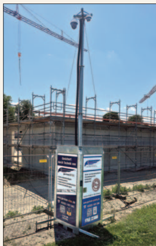
■ Videotürme haben sich beim Objektschutz bewährt.
